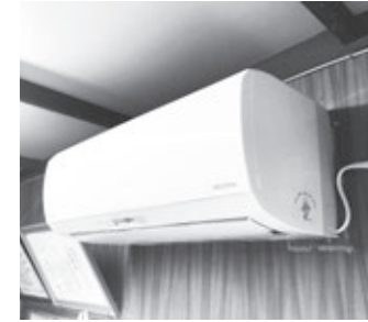
整備した備品 テーブル・エアコン
