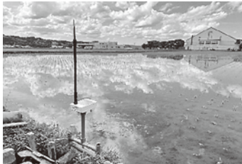
水位・水温を自動測定し遠隔操作できる「水管理システム」
