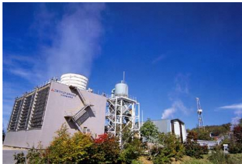
大沼地熱発電所
