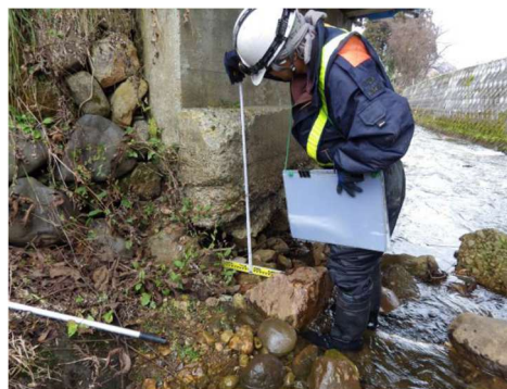
洗掘（橋台基部）
