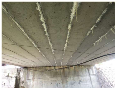
遊離石灰（間詰部）
