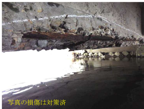
鉄筋露出（主桁）
