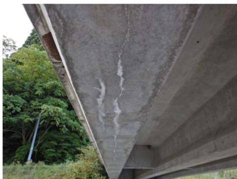
ひびわれ（主桁）
