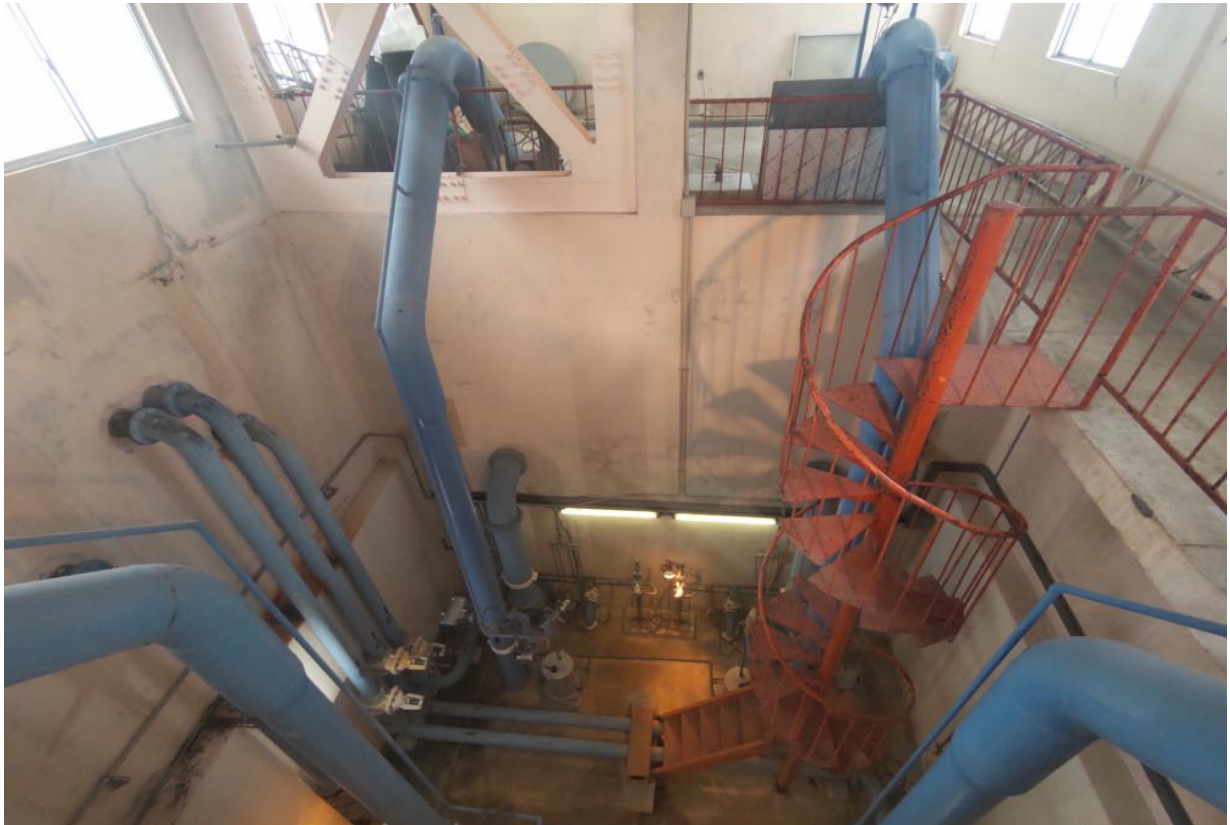
花輪浄水場 花輪系ろ過池
