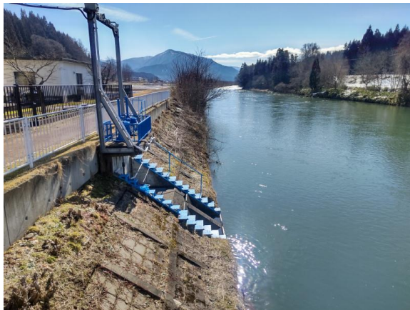
花輪浄水場 米代川表流水
