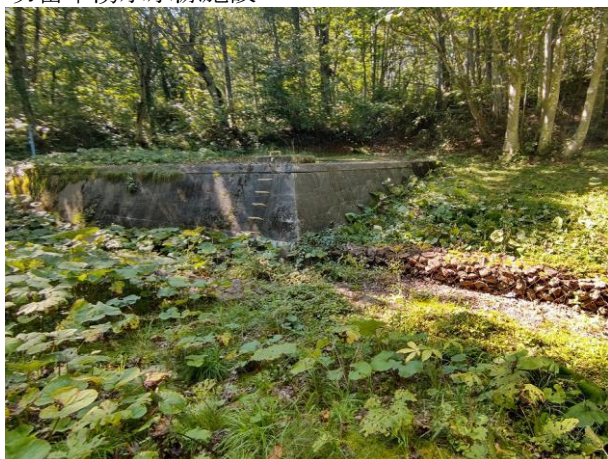
切留平湧水水源施設
