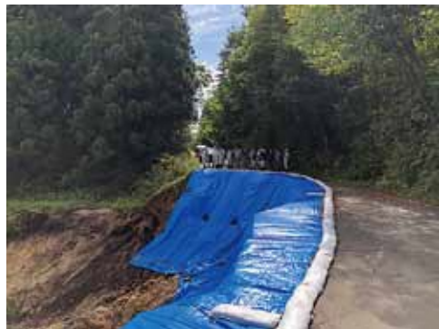
西山農免道路崩落の現場
