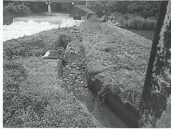
8月の大雨で被災した水路
