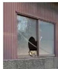
窓が割れた 管理不全空家
