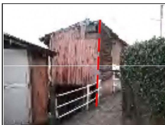
一部の柱が傾斜している例
