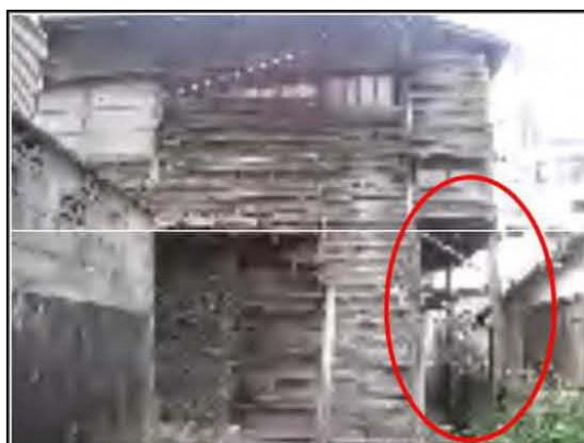
柱の数ヶ所に破損がある例
